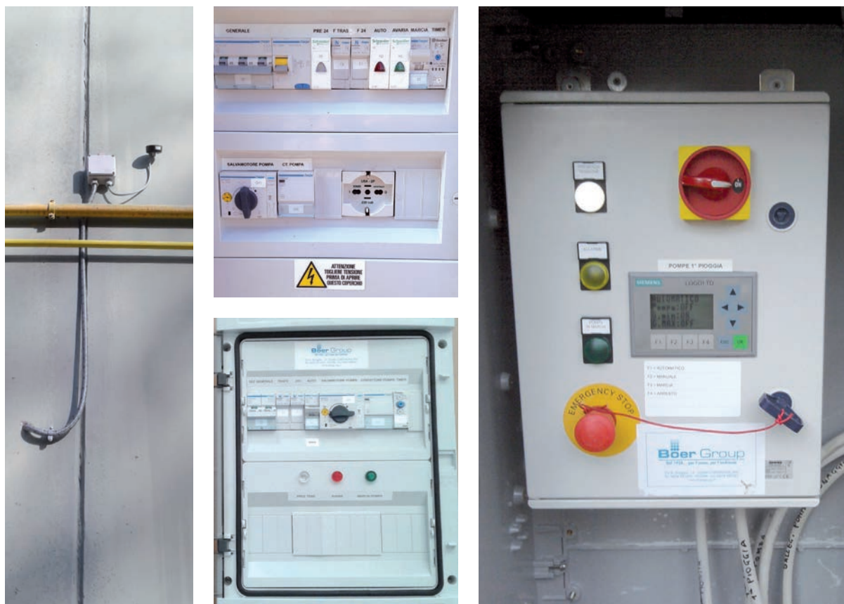
Quadri elettrici ed apparecchiature.
